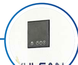
SISTEMA DE ALARMES
