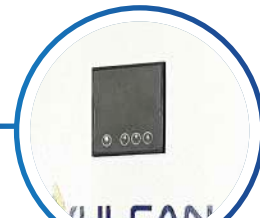
SISTEMA DE ALARMES
